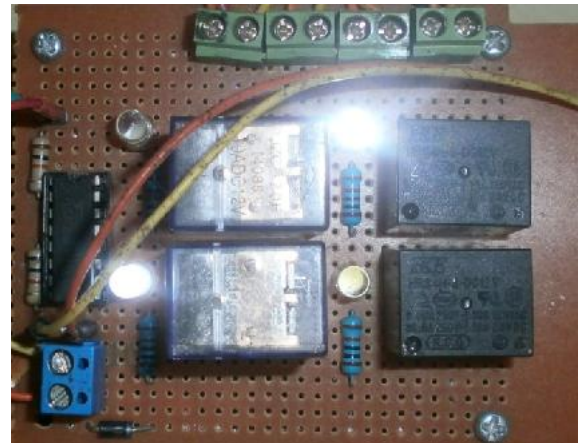
Gbr. 13 Kondisi Relay 2 dan Relay 3 aktif
