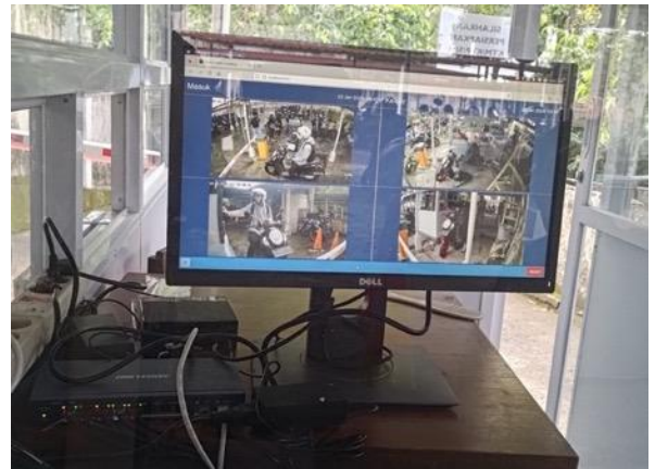
Gbr.11 Implementasi mini PC dan switch dalam ruang operator.
