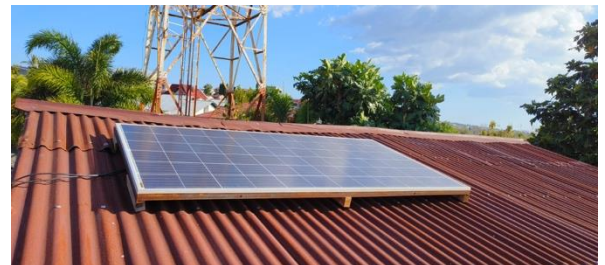
Gbr. 3 Penempatan modul panel surya pada atap rumah
